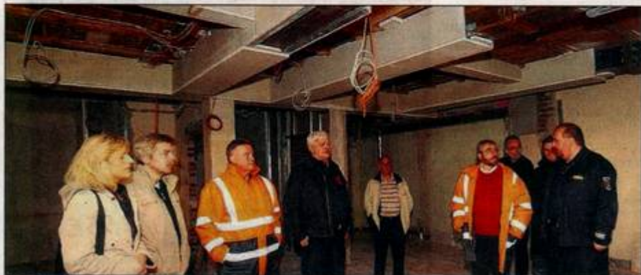
OB Dehm ließ sich von Mitgliedern der FF Boele-Kabel über den Fortschritt des Umbaus der Turnhalle zur Feuerwache an der Steinhausstraße 49 informieren. Fotos: Richard Holtschmidt
